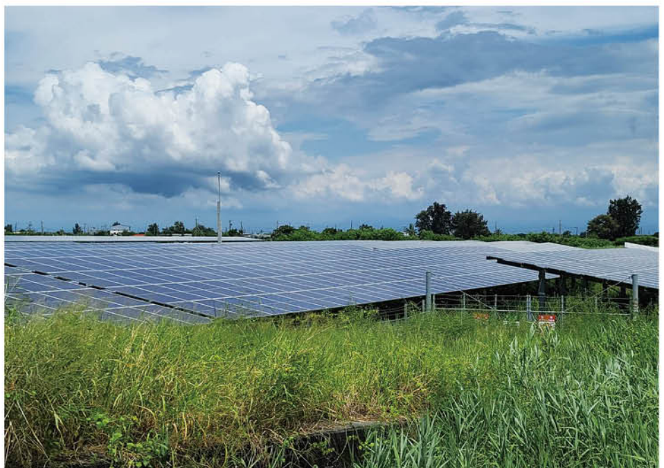
太陽光電板 ( 電伏板 )
